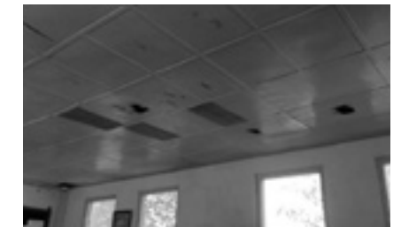
▲雨漏り等で無数の箇所に穴が開いた教室のベニア板の天井。応急処置もままならない
