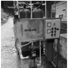
▲水源地から取り入れた水は浄水器で浄化され、タンクから供給される
