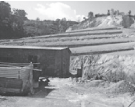
▲山肌を削り造成工事が進められているカトマンズ郊外
