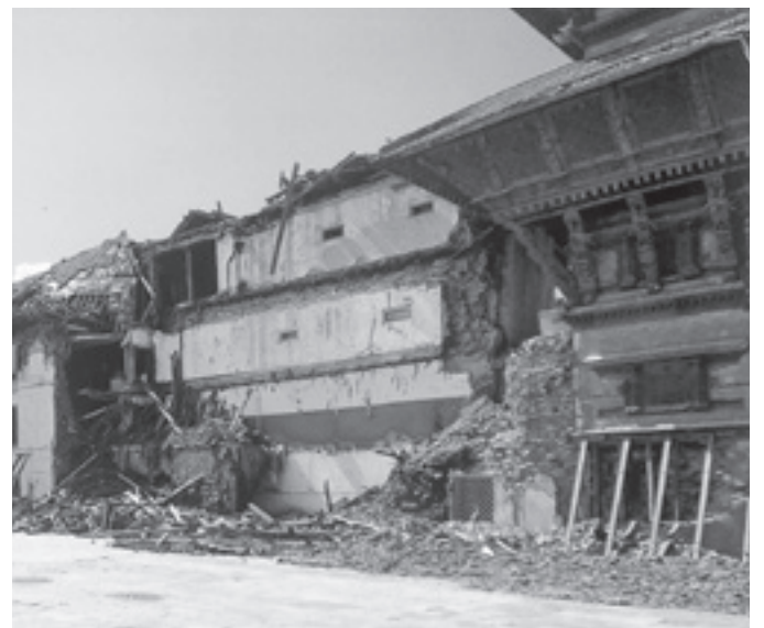
▲瓦れきはだいぶ片づいてきているが、建物の取り壊しや修復はまだこれから
