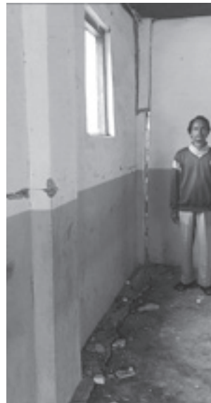
▲大きく損壊したバシフアント校の3年生の校舎
