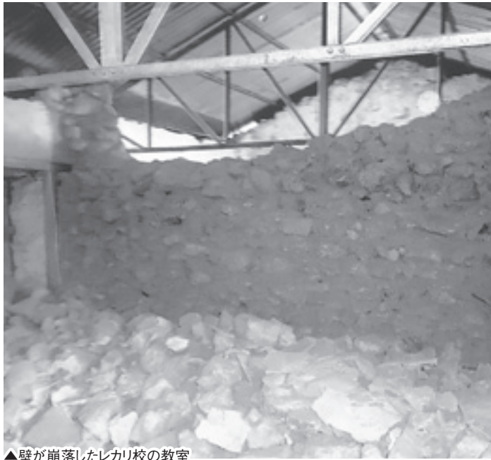
▲壁が崩落したレカリ校の教室
